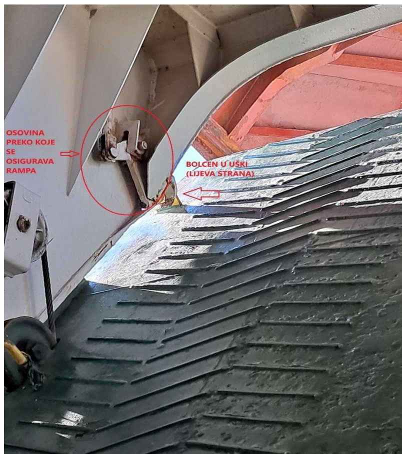
Slika 12. Mehanizam za mehaničko osiguranje pramčane rampe, pogled iz palube vozila (garaže) prema lijevom dijelu pramčane rampe iz položaja s kojeg se upravlja ručicom pramčane rampe (izvor: AIN)
