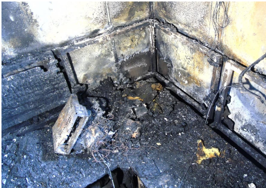
Slika 6. Centar požara u kutu kabine 1 s termički destruiranim potrošačima (izvor: AIN)
