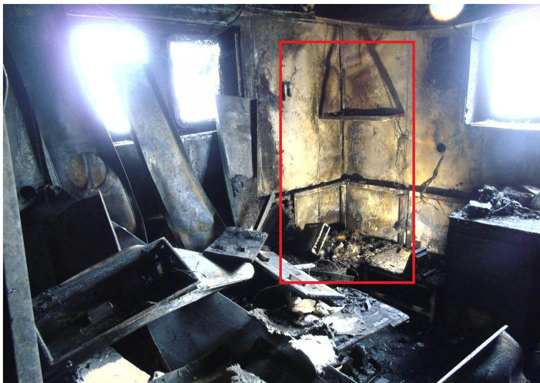
Slika 4. Kabina 1, s označenim područjem izvora požara u kutnom dijelu kabine (izvor: AIN)
