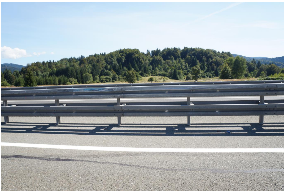
Slika 3 – Oštećenje ograde autoceste
