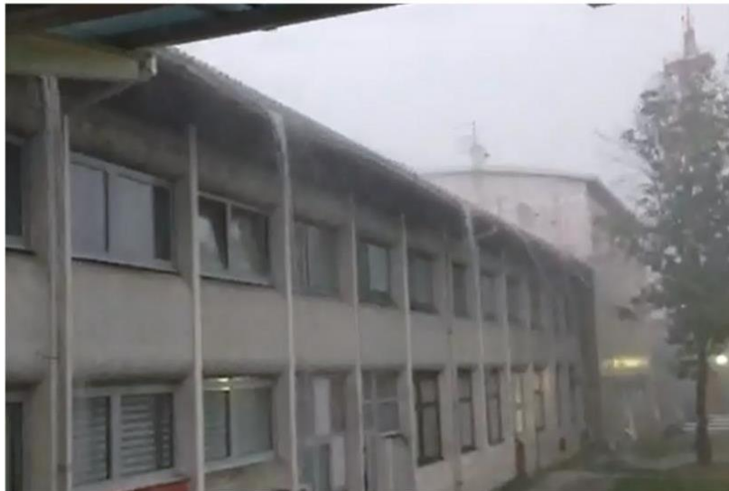
Slika 1. Slijevanje oborinske vode van žljebova na staroj zgradi HKZP-a, Izvor: V.1.4, SAF-INV-2014-05 [1]
