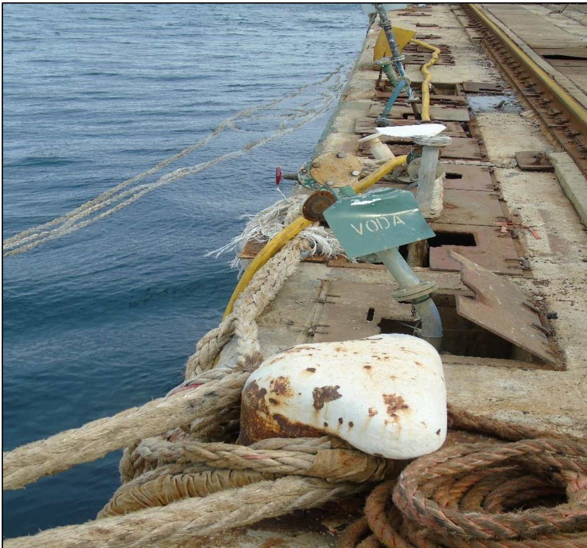
Slika 8. Vidljiva oštećenja na Obali VIII s koje je platforma otrgnuta (izvor: AIN)
