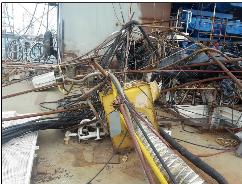
Slika 10. Vidljiva oštećenja na palubi platforme uslijed otrgnuća s Obale VIII (izvor: AIN)
