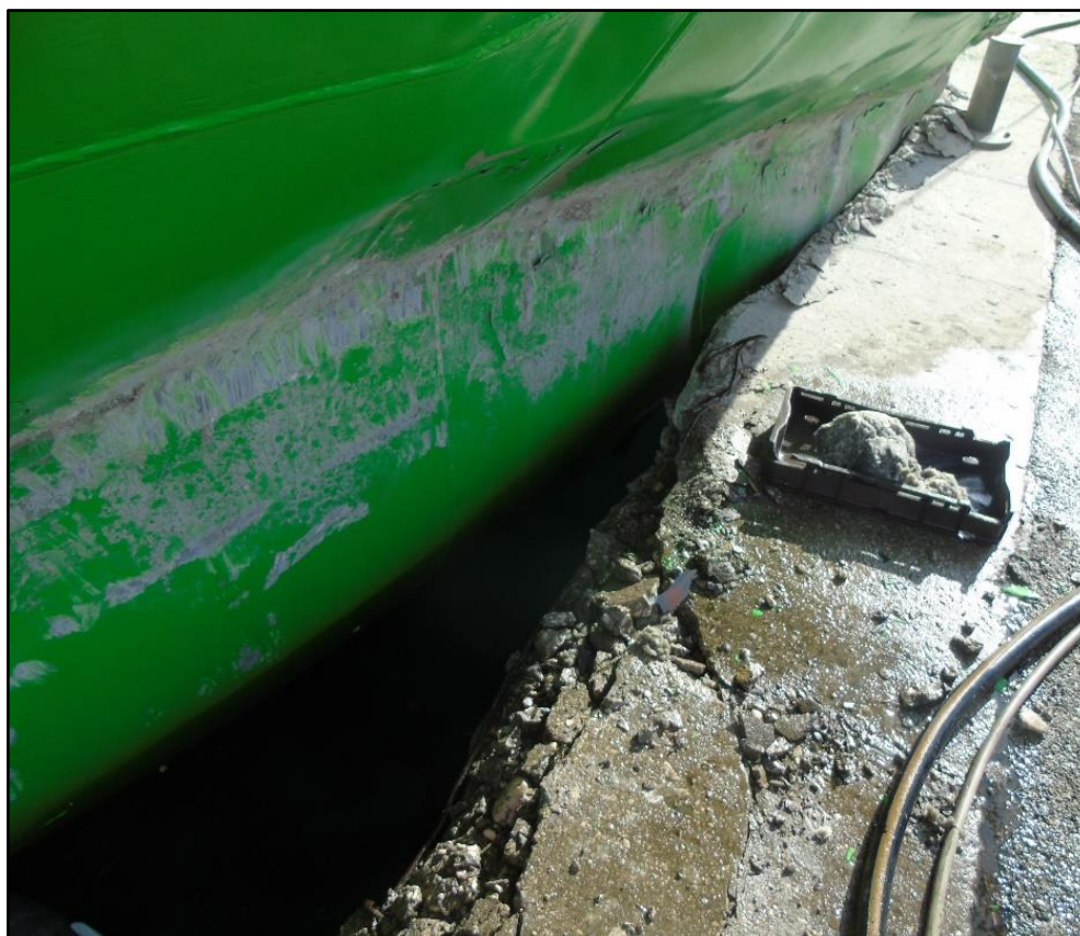
Slika 12. Vidljiva oštećenja na gatu Molo Carbone i pramčanom (lijevom) dijelu platforme uslijed udara platforme u gat (izvor: AIN)
