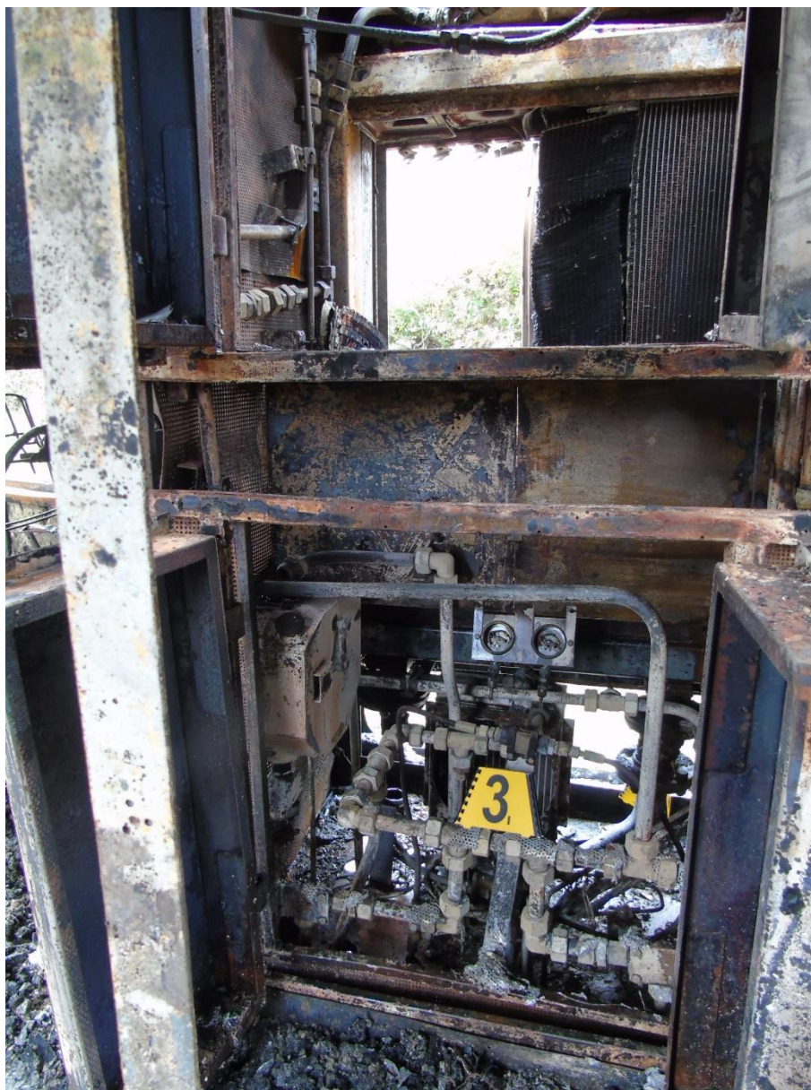
Slika 8. Prostor hladnjaka na garnituri 7121 -101 (Izvor slike: AIN)
