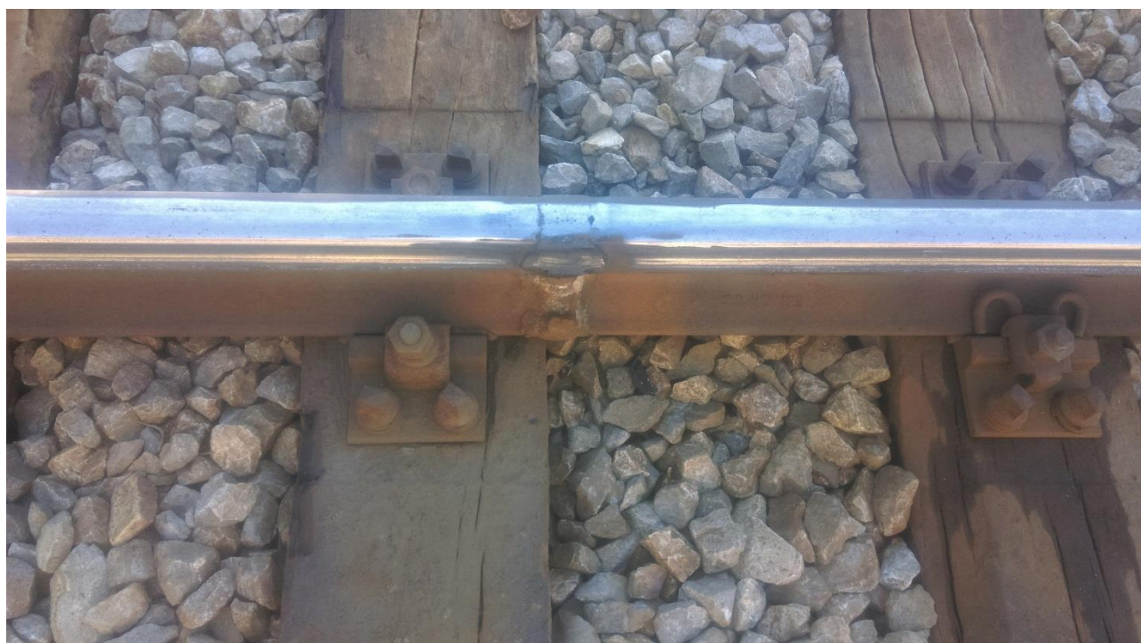
Slika 9. – Puknuća tračnice u km 630+750 (izvor slike: Željeznički prijevoznik )
