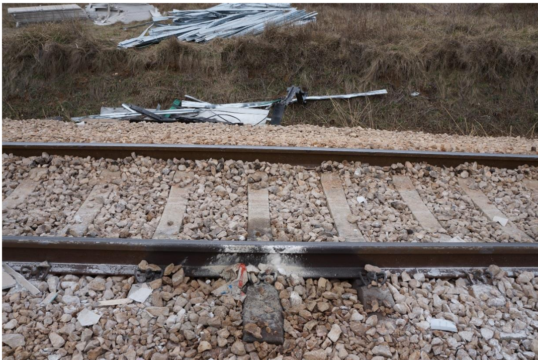
Slika 6 Oštećenja na gornjem ustroju pruge (Izvor AIN)
